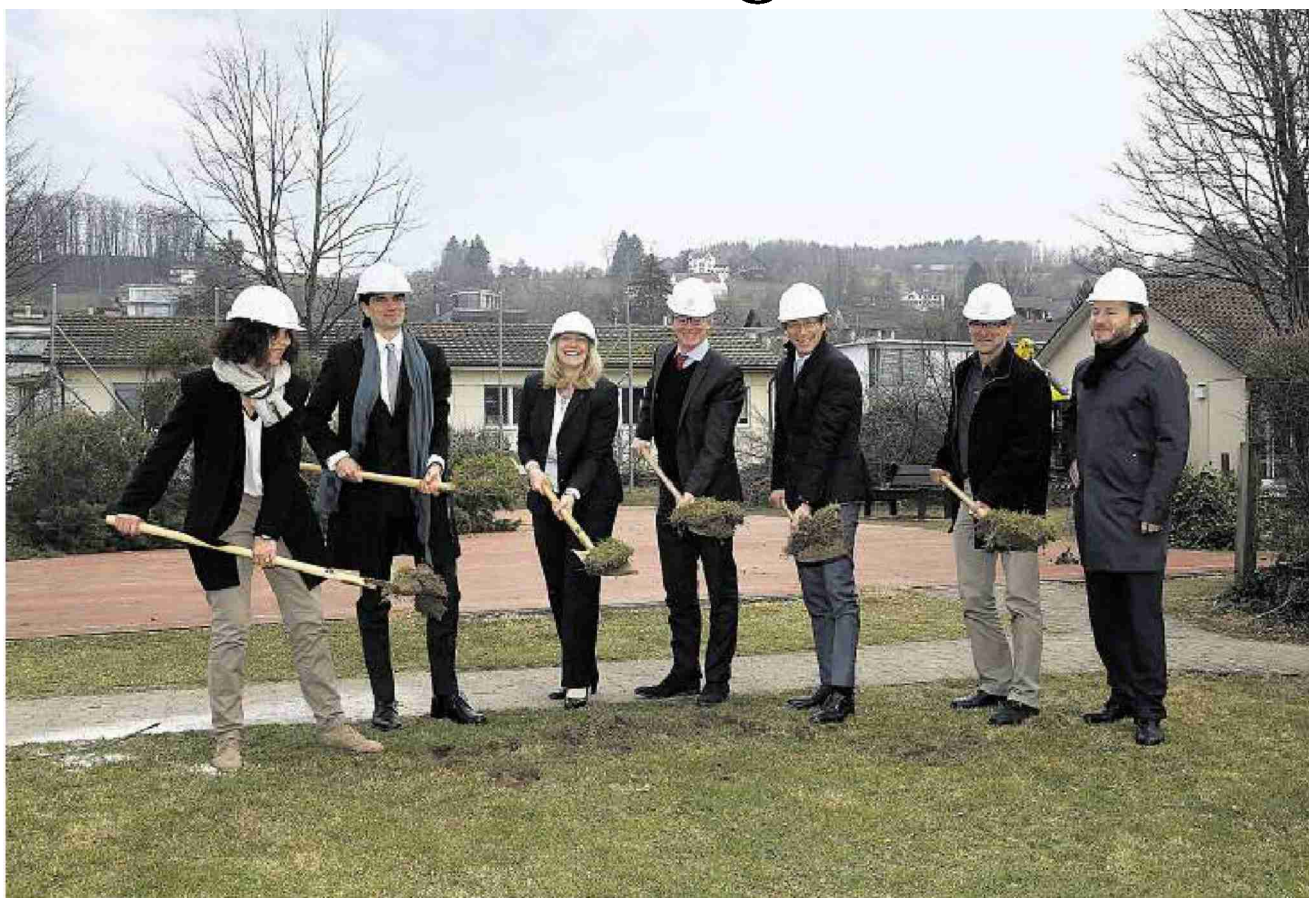
Mit dem Spatenstich begannen die Bauarbeiten für die Sanierung und Erweiterung der Kinderklinik Brüschhalde.
